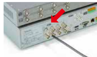
カメラに接続した同軸ケーブルをレコーダー背面の「映像入力」に接続します。
